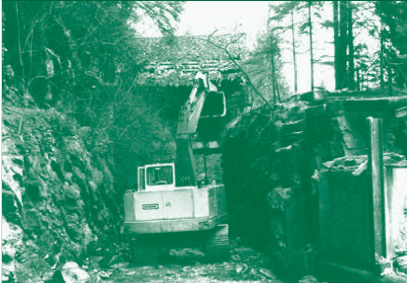
1984 wurden das Eichenhaus und die „Oberen Läden“ abgebrochen, der Einlass in den Triftkanal mit einer Betonmauer stark verkleinert.
